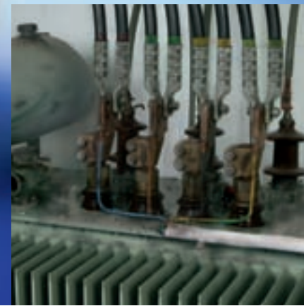
Transformator vor der Reinigung
